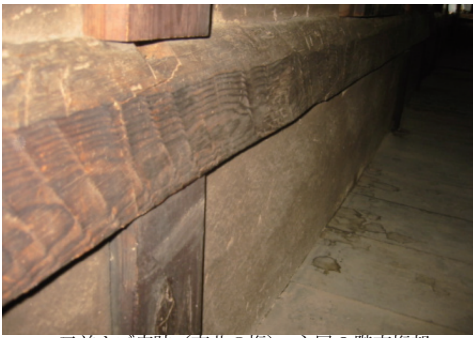
又首ホゾ痕跡（南北の桁） 主屋2階南桁部
