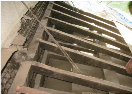
玄関上部吊金物 (9ミリ角鍛金 錠)
